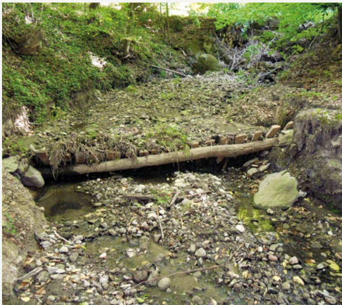
A fésűs hordalékfogó mögötti feltöltődéssel mederlépcső keletkezett, s a széles és kis esésű mederszakaszon csökken az időnként összegyülekező nagyvizek sebessége (©KB)
