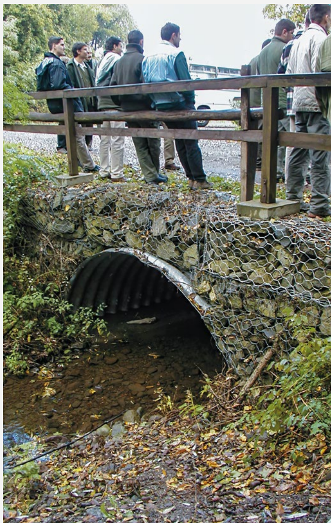
Gabion-előfejjel védett nagy méretű hullámacél áteresztő (©KuM)
