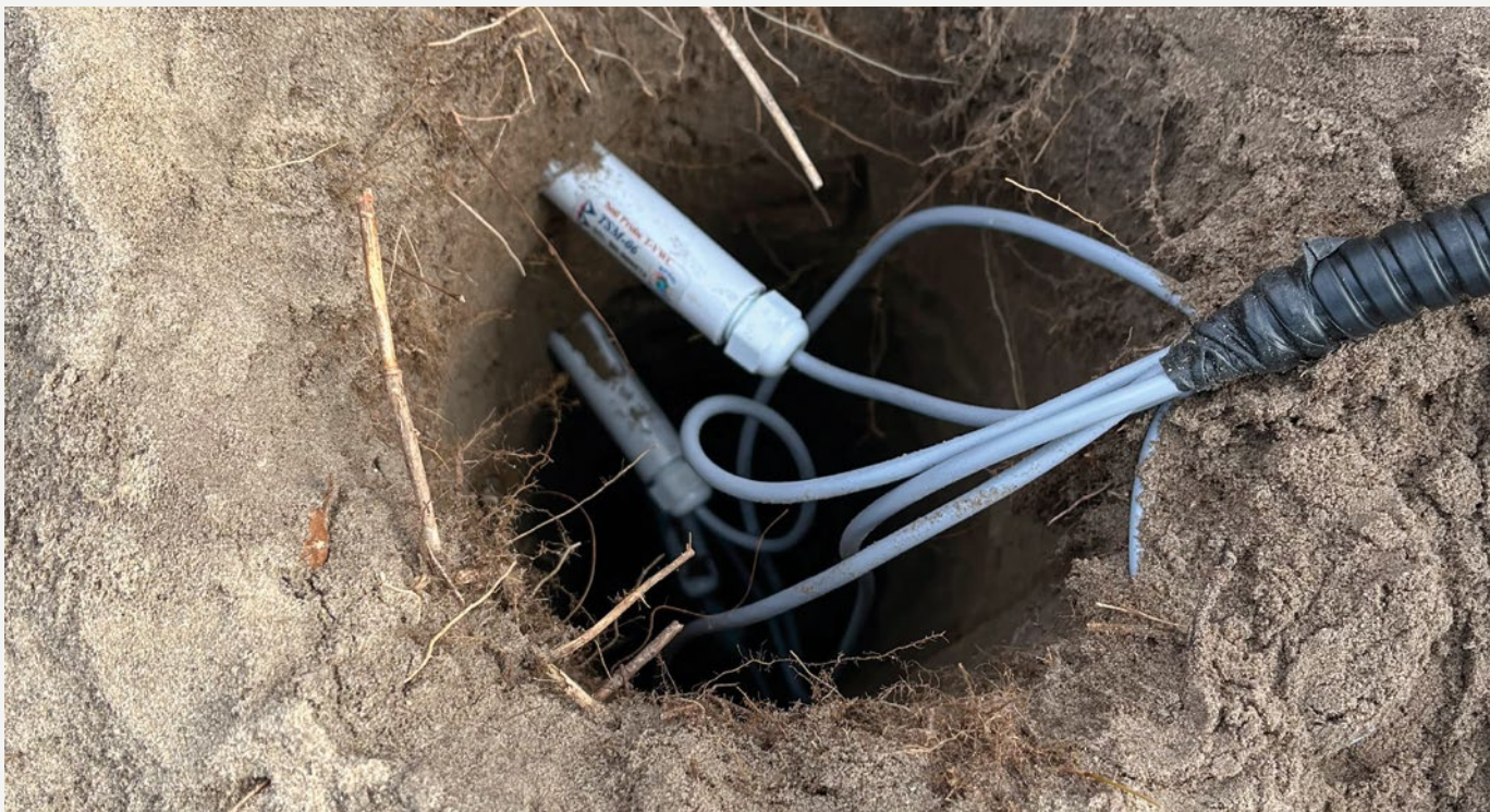
Talajnedvesség és -hőmérséklet érzékelő szondák telepítése az ERTI monitoring területén (fotó: Bolla, B.)
